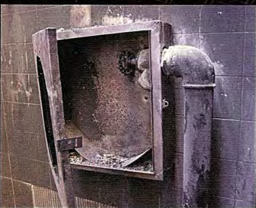
Gabinete contra incendios que presuntamente no tenía su abastecimiento de agua funcionando en el momento del incendio. (Foto cortesía de Diario ABC Color, Asunción)
