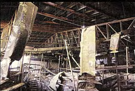
Área de ventas después del incendio. La estructura que soporta el techo se puede ver sin ningún recubrimiento resistente al fuego. (Foto cortesía de Diario ABC Color, Asunción)
