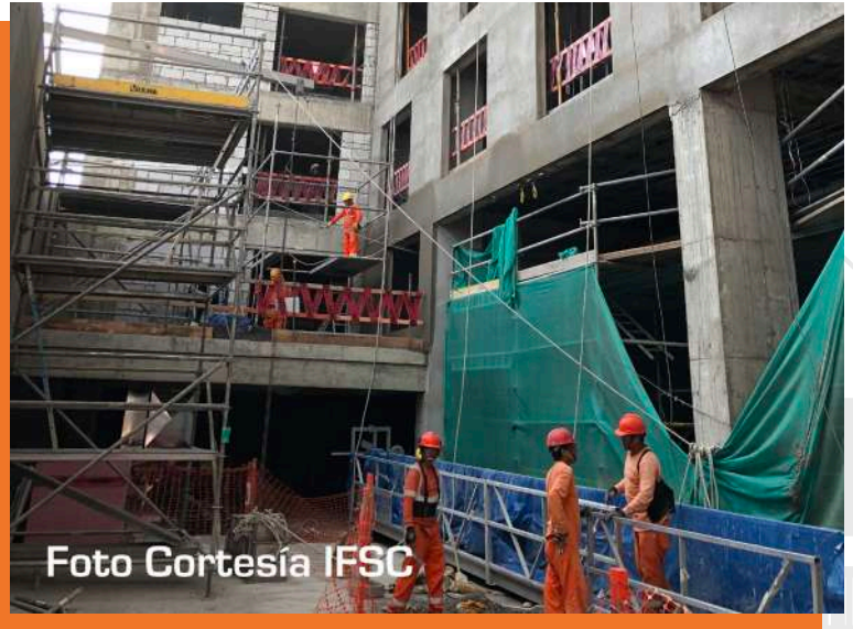
Edificio en construcción con fachadas abiertas, escaleras y sectorización corta fuego sin terminar (Foto cortesía IFSC).
