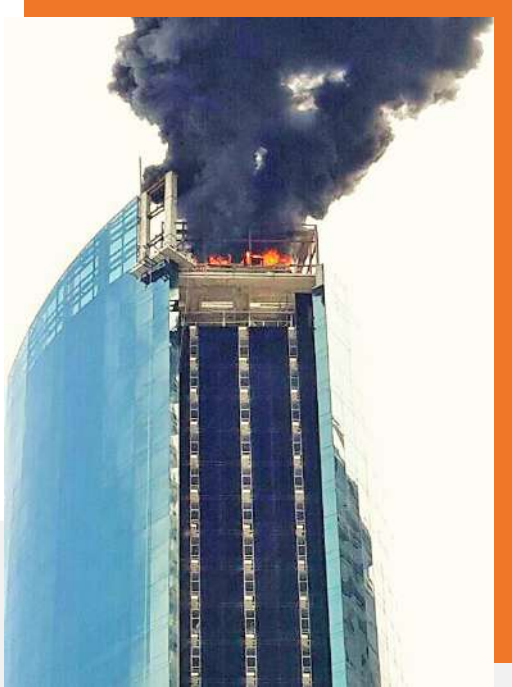
Incendio en la torre de enfriamiento en la azotea de esta torre de 52 pisos (Foto cortesía del Cuerpo de Bomberos de Panamá).
