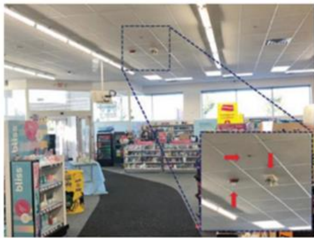
Imagen 2. Rociadores automáticos, alarma sonora y estrobo, e iluminación de emergencia protegiendo un supermercado mediano.
