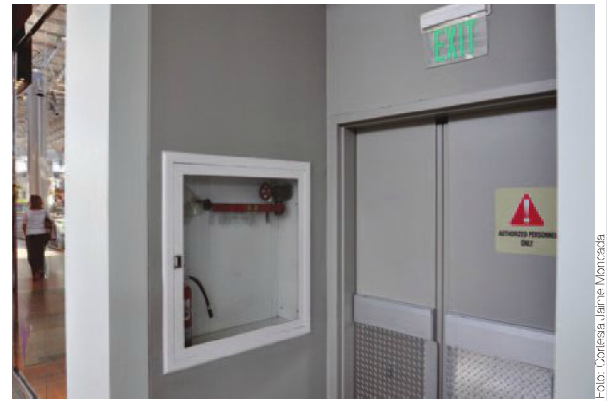
Gabinete con una conexión para manguera de 2-½" anexo a la puertas de evacuación en la galería peatonal cubierta. Por no ser requerida, la manguera se ha retirado por el dueño de la instalación
