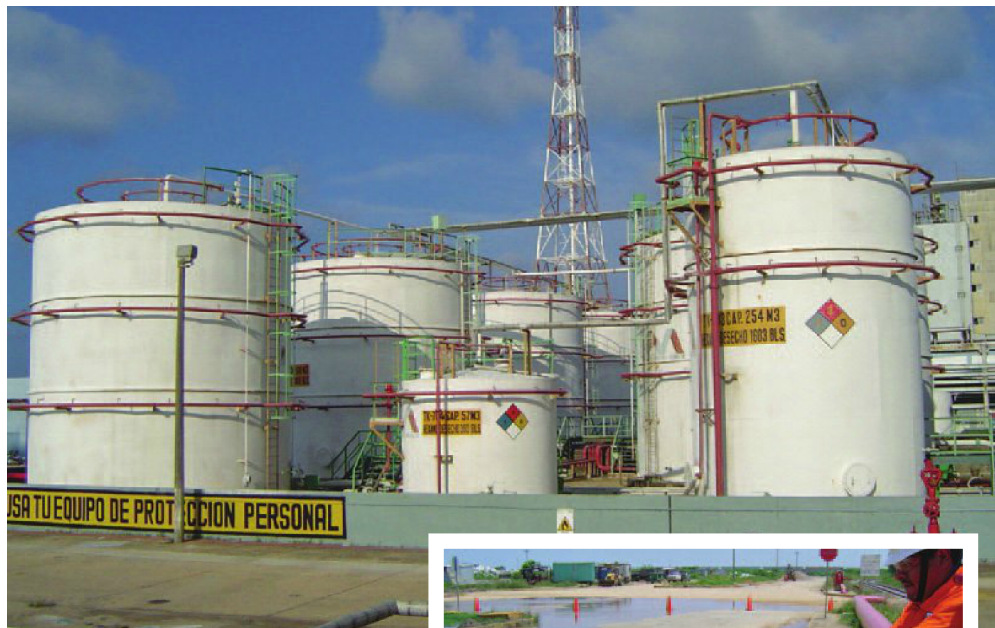
Área de proceso protegida con sistemas fijos de aspersión de agua
