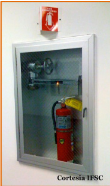
Imagen 1- Gabinete de mangueras donde se ha retirado la manguera. Foto Cortesía IFSC
