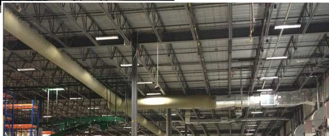
Centre de distribution de pièces électriques Electrical parts distribution center- 279 m 2
