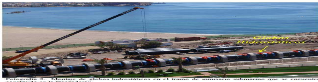
Fotografía 3- Montaje de globos hidrostáticos en el tramo de inmisario submarino que se encuentra construido en la "lanzadera".
