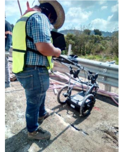
Fotografía 1. Barrido de la antena de Radar en la zona afectada por fracturas en pavimento.
