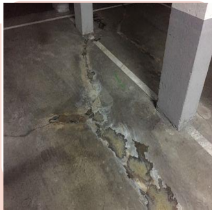
Fugas de agua
