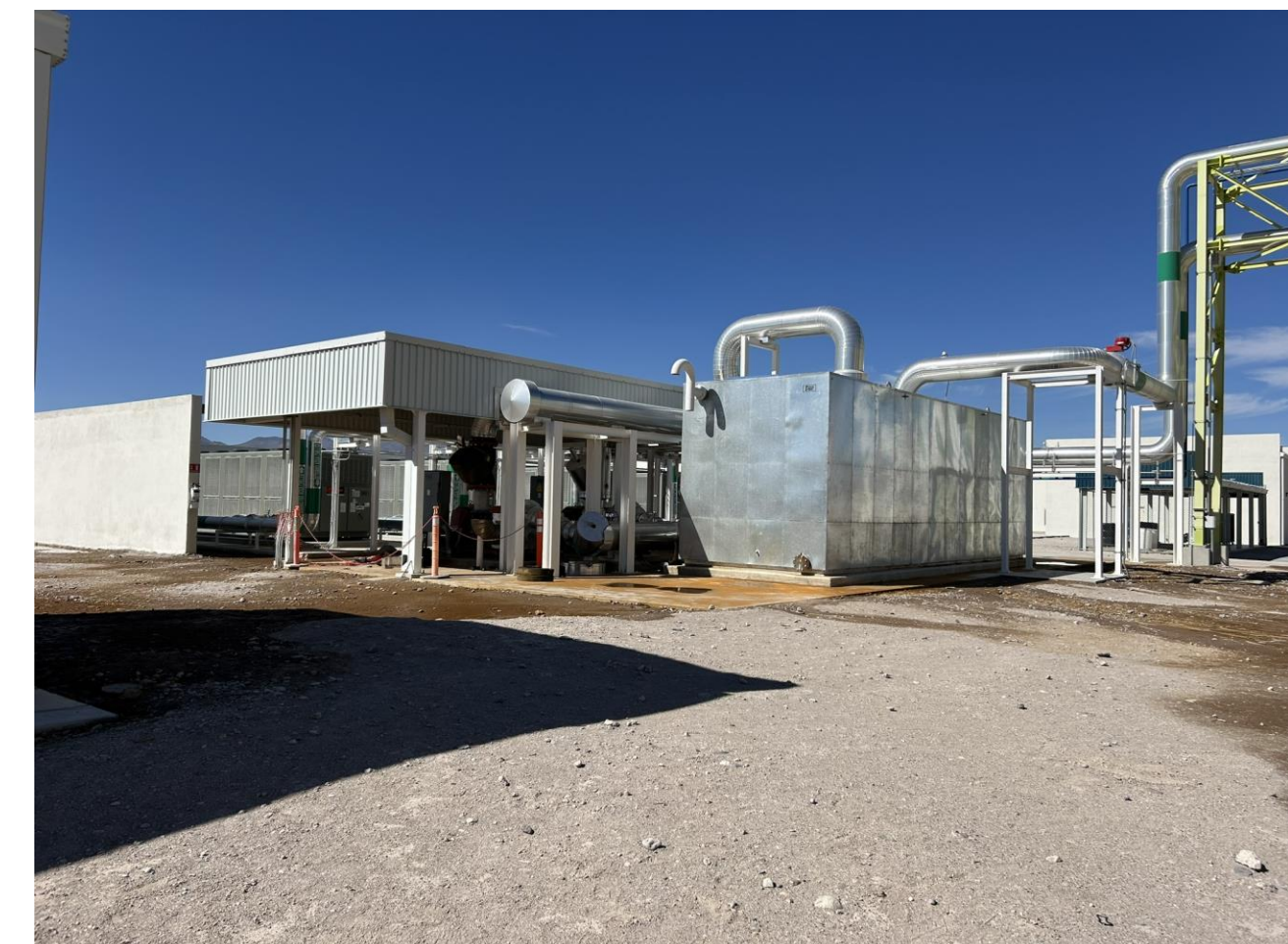
Sistema de agua helada
