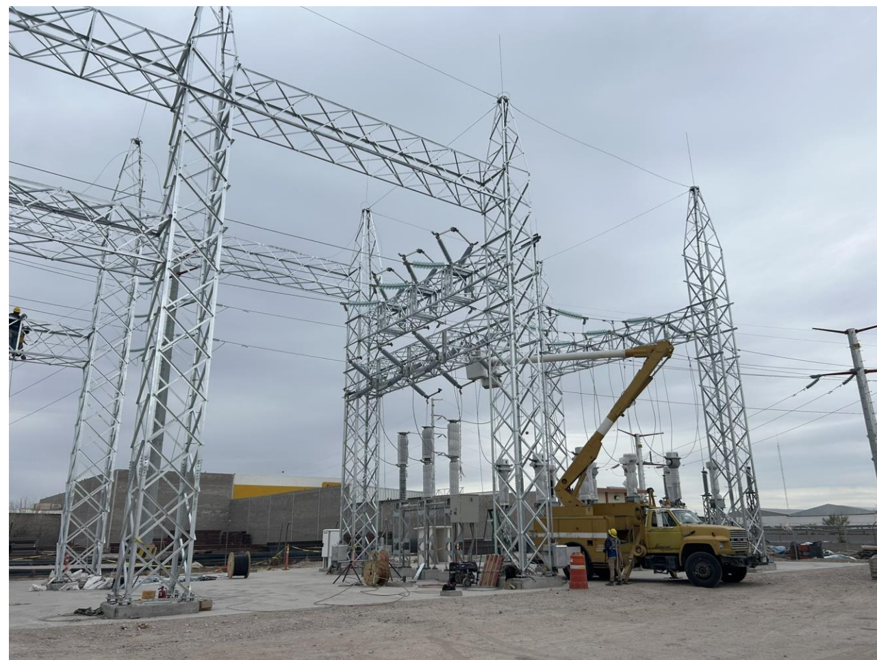
Subestación eléctrica 115,000 V
