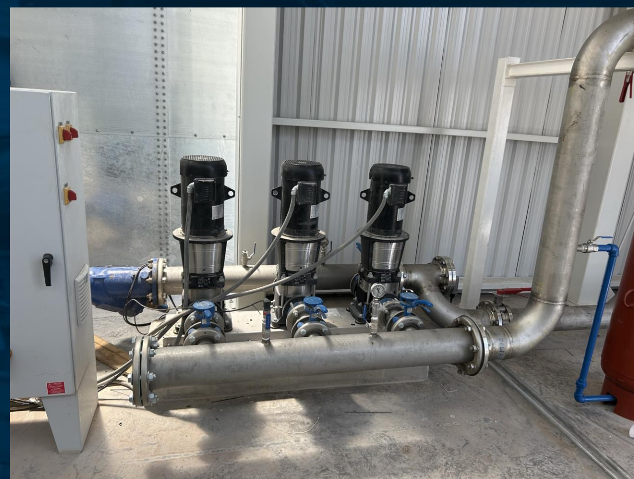
Sistema de bombas triplex
