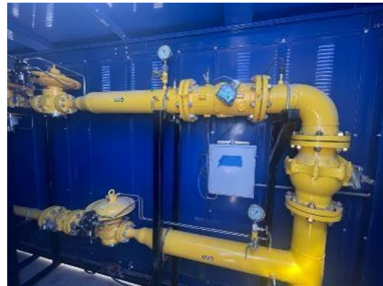
Caseta de descompresión de gas natural
