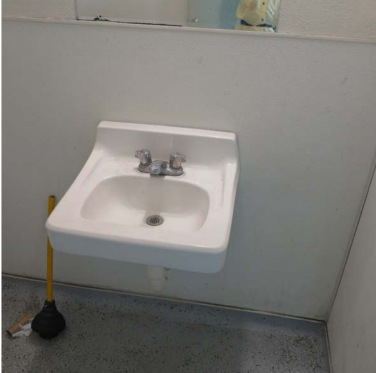
Non compliant faucet
