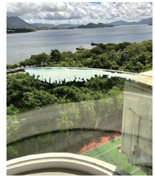
違建工程「擅自改建玻璃欄障」
