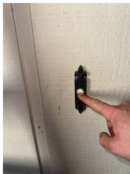
Inoperable door bell
