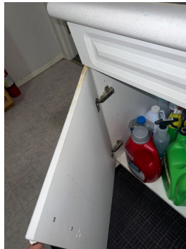
Loose cabinet door hinges
