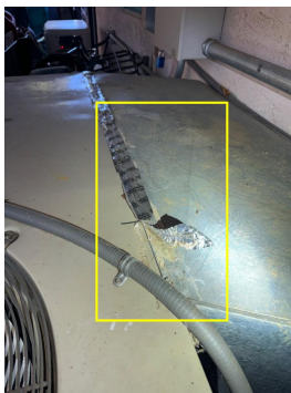
Deficient plenum seal
