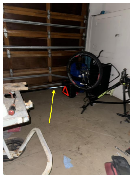
Deficient door weatherstripping
