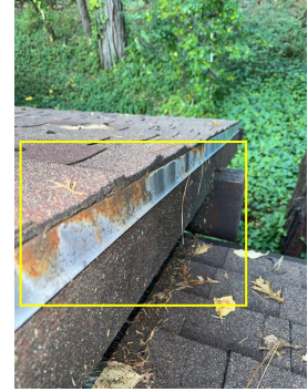
Rusted edge flashing
