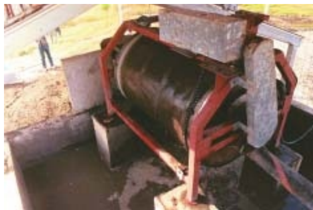
Laguna de oxidación
