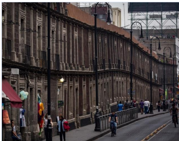
Figura 3. Efecto del hundimiento diferencial en edificaciones del Centro Histórico
