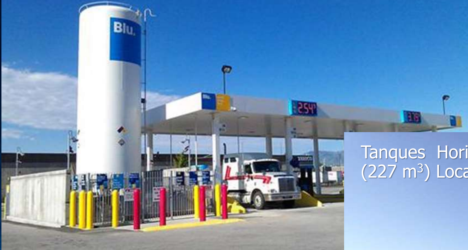
Tanque Vertical de GNL en Estación de Servicio Localidad: USA
