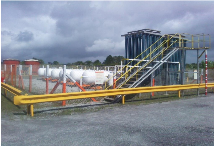
Figura 2.4 – Central de Gás na Usina de Asfalto (ECOVIAS)
