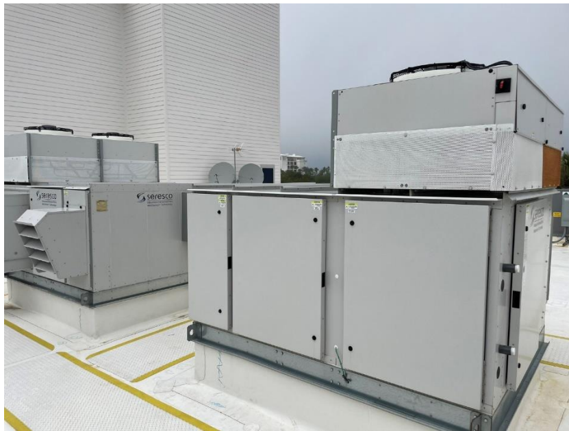
Dehumidifiers (Exterior Units)
