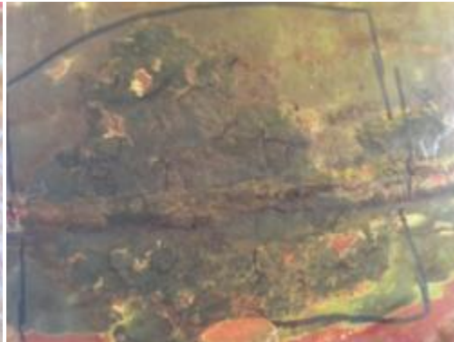
Foto No. 2 Perdida de espesor por corrosión externa en área paralela al cordón de soldadura en la posición horario de las 04:00 en el codo del String 1
