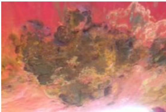
Foto No. 3 Perdida de espesor por corrosión externa en área ubicada a aproximadamente 7 cm del cordón de soldadura en la posición horario de las 06:00 en codo del String 3
