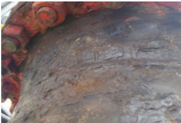
Foto No. 11 Defecto de 22 cm x 16 cm en posición horario de las 06:00.
