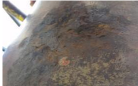
Foto No. 10 Tercer defecto encontrado en el String 3.
