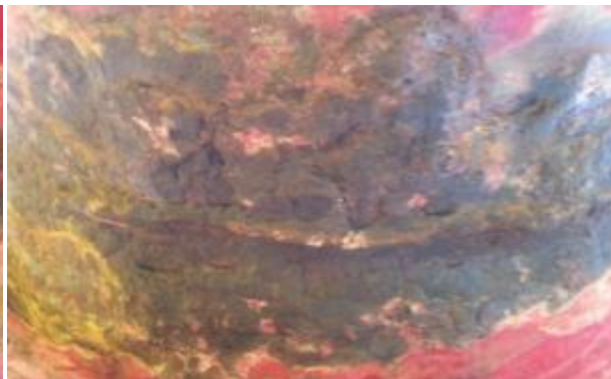
Foto No. 4 Perdida de espesor por corrosión externa en área paralela al cordón de soldadura en la posición horario de las 06:00 en el codo del String 3
