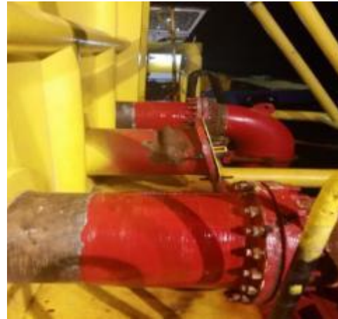
Foto No. 16 Aplicación de revestimiento de poliuretano para protección de los rayos UV.
