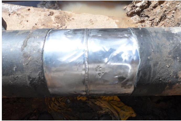
Fig. 2. Defecto post-limpieza mecánica.
