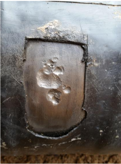
Fig. 1. Defecto previo a limpieza mecánica.
