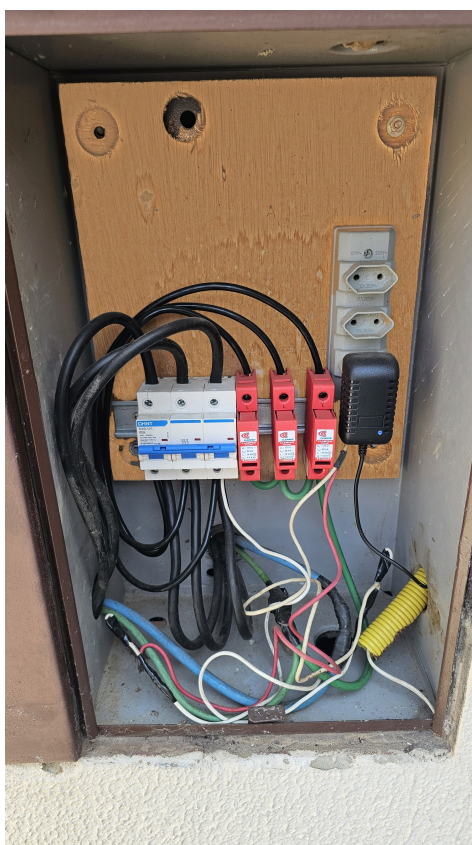
Figura 2.1: Caixa do padrão de entrada da residência: disjuntor geral, três DPS e condutores.
