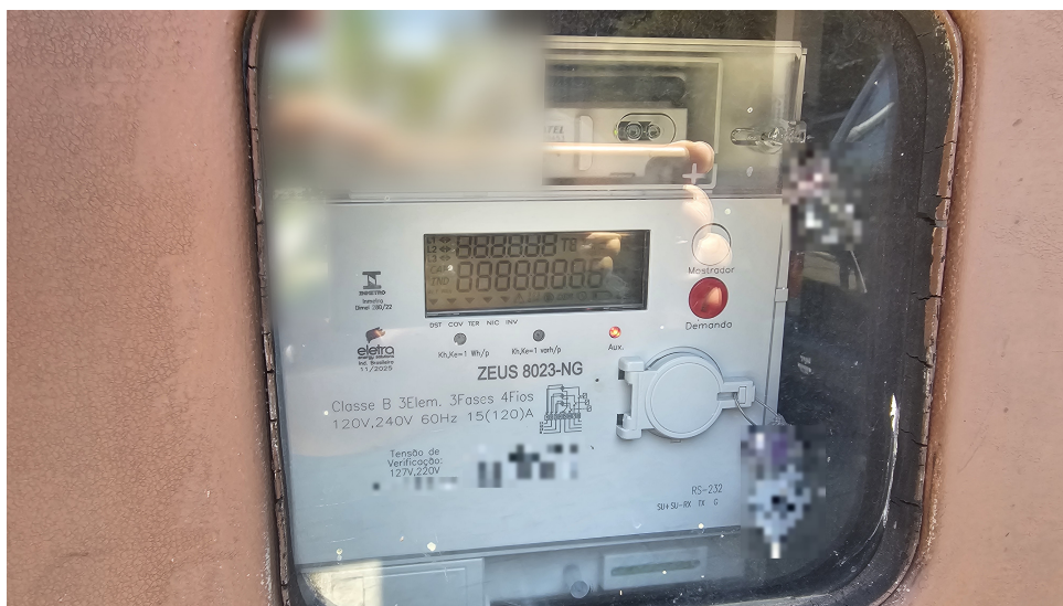
Figura 2.2: Medidor Eletra ZEUS 8023-NG da CPFL. Leia a placa junto com a tabela abaixo.
