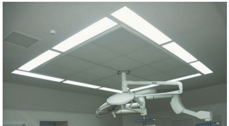
Laminar Air Flow -Diffuser
