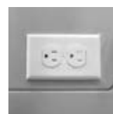
Double electrical receptacle on left side Prise électrique double sur le côté gauche
