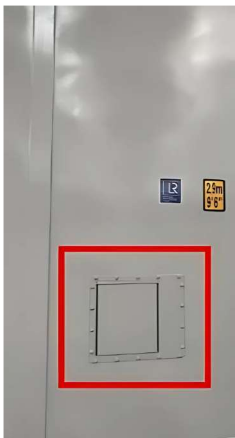
Figura 8-2 (6) Immagine della presa d'aria
