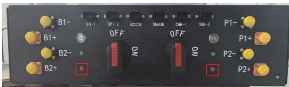
Figura 7-1-2 (4) HV BOX-DC 1500V alimentazione accesa
