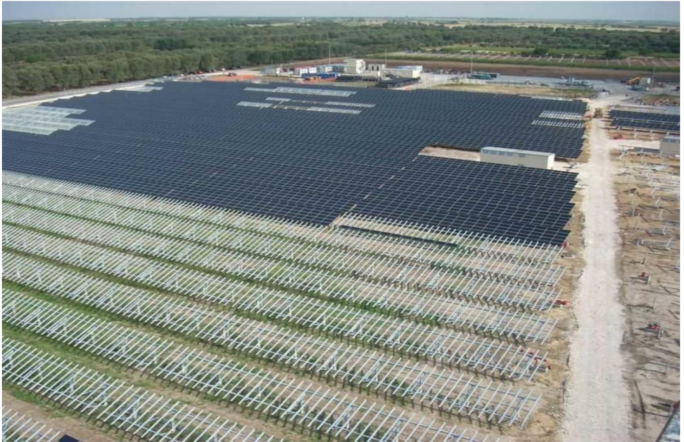
IMPIANTO FOTOVOLTAICO 43 MW COMUNE DI CELLINO SAN MARCO BRINDISI COMMITTENTE: D'AGOSTINO COSTRUZIONI S.R.L.
