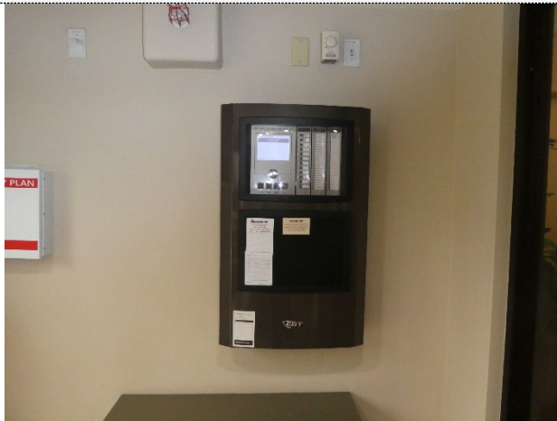
EST notifier panel
