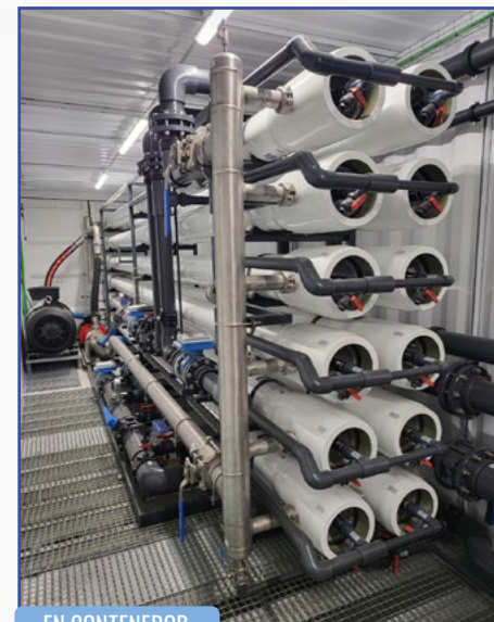
EN CONTENEDOR CONTAINERIZED
