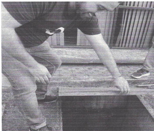
Filtraciones en cisterna de aguas pluviales
