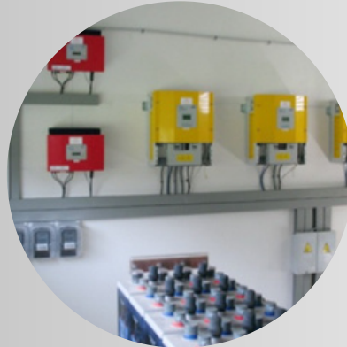
SISTEMA FOTOVOLTAICOS INTERCONECTADOS A LA RED DE C. F. E.
