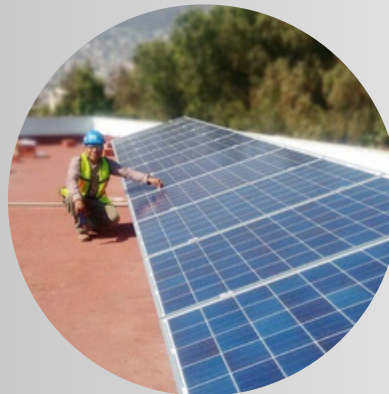
MANTENIMIENTO ELÉCTRICO Y SOLAR
