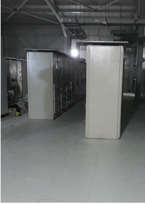
Musul GE Elektrik Santrali
