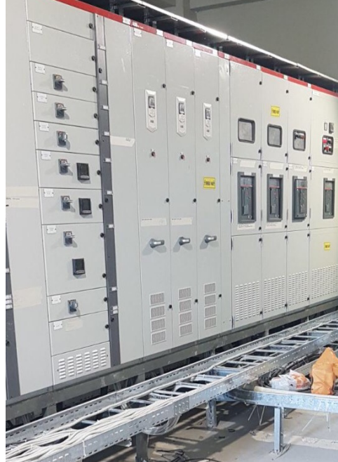
BaTISÖKE Çineto Elektrik Odası
