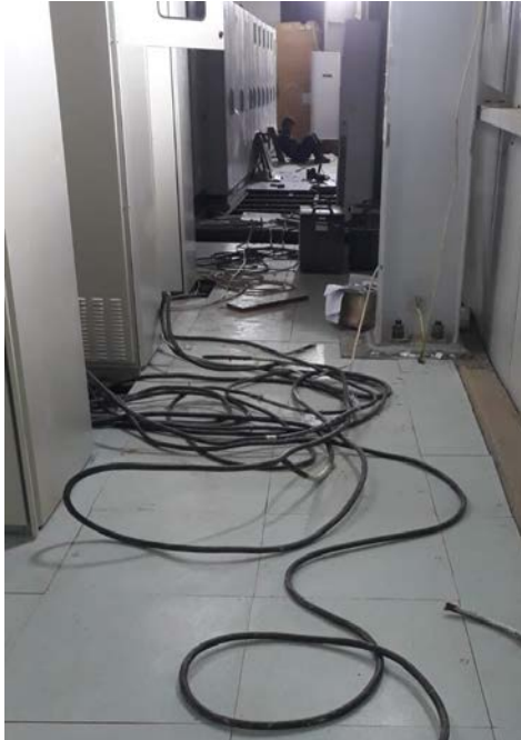
MUSULGE Elektrik Santrali,
