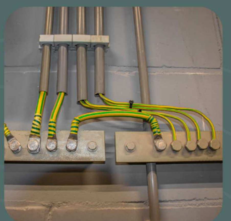
تأريض كهربائي لكامل المبنى
