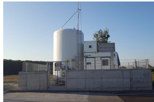
Beispiel einer Tankanlage
