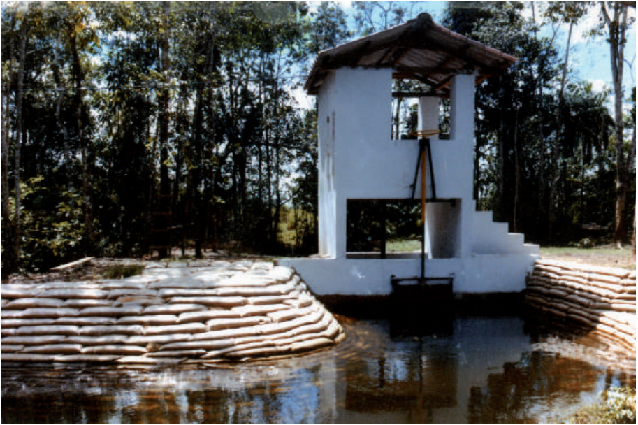
Presas y casa de máquinas de la turbina hidráulica GAVIOTAS de baja caída para generar electricidad
