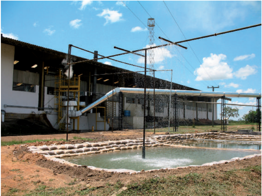
Aspecto de la cogeneración eléctrica a partir de la planta de colofonia de GAVIOTAS (en los estanques de agua se crían cachamas) peces nativos de la Orinoqia
