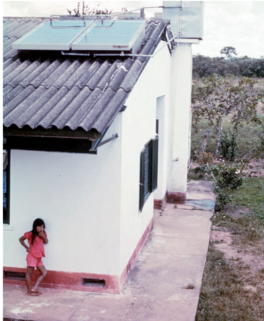
Primer calentador solar para agua caliente en GAVIOTAS Vichada
