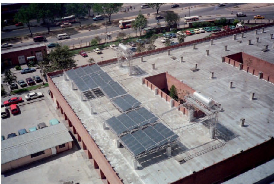
Instalación solar de GAVIOTAS para agua caliente en el Hospital Méderi en Bogotá
