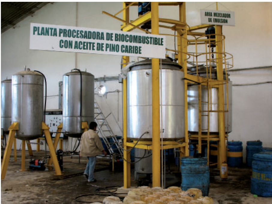
Vista general de planta procesadora de biocombustible con aceite de pino
