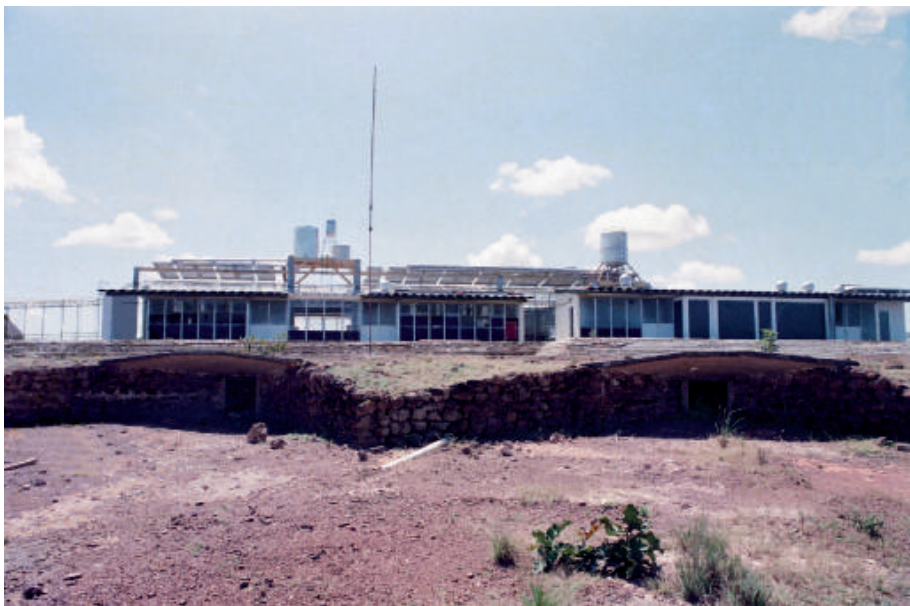
Ductos subterráneos de ventilación de la envasadora de agua natural tropical en GAVIOTAS
