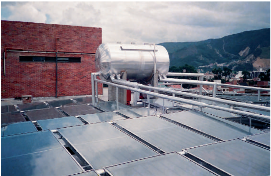
Instalación solar de GAVIOTAS para agua caliente en un hotel de Bogotá
