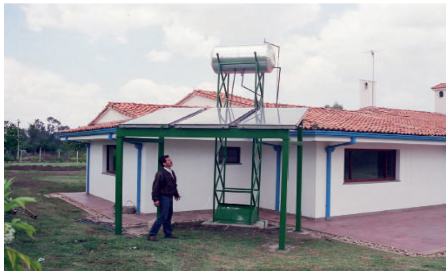
Instalación solar de GAVIOTAS para agua caliente en el área rural de Tenjo
