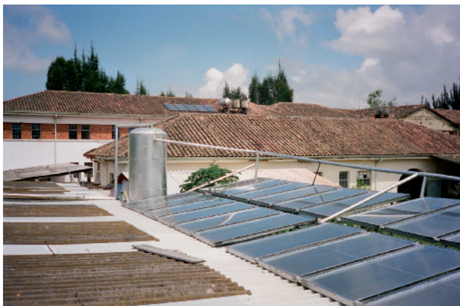
Instalación solar de GAVIOTAS para agua caliente en un asilo de ancianos
