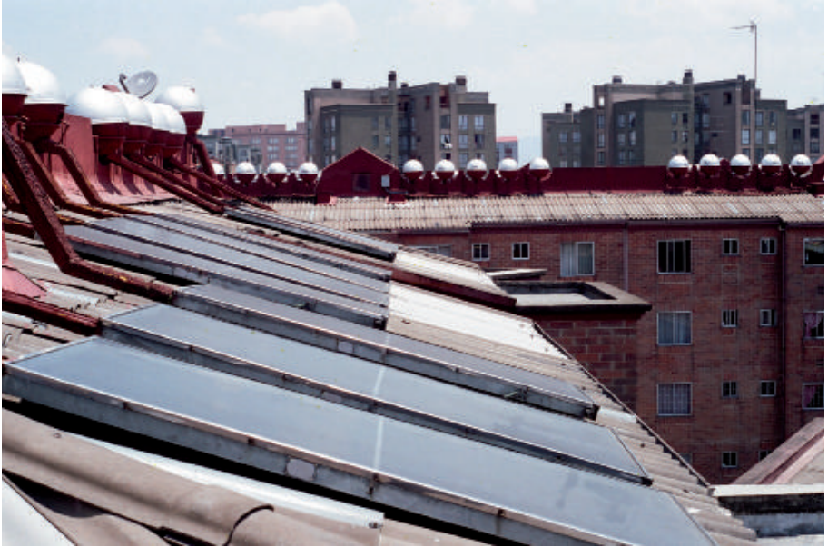
Instalación solar de GAVIOTAS para agua caliente en 1.100 apartamentos de la urbanización Sausalito en Bogotá
