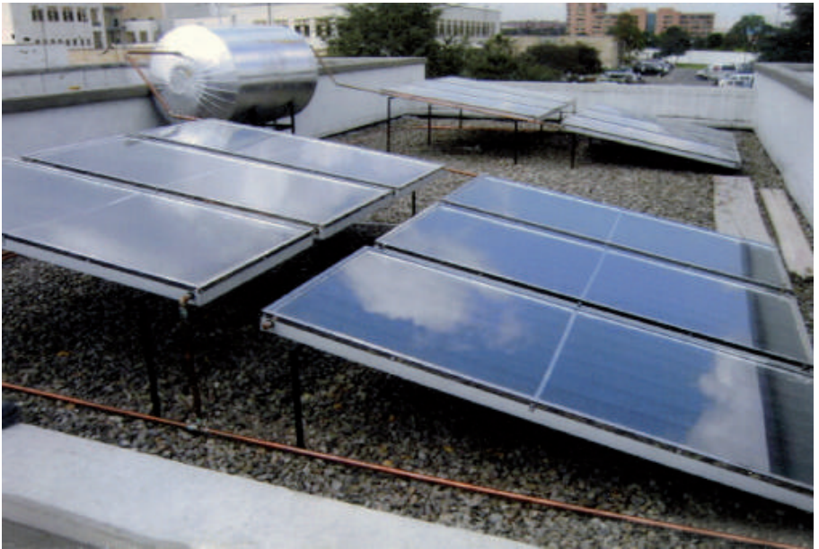
Instalación solar de GAVIOTAS para agua caliente en la Embajada Americana de Bogotá
