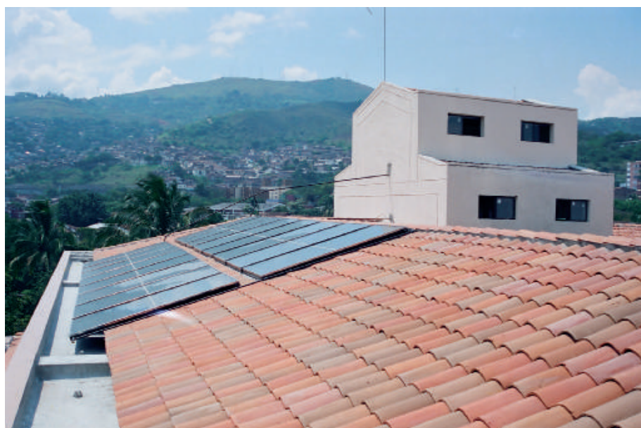
Instalación solar de GAVIOTAS para agua caliente en una comunidad religiosa de Cali
