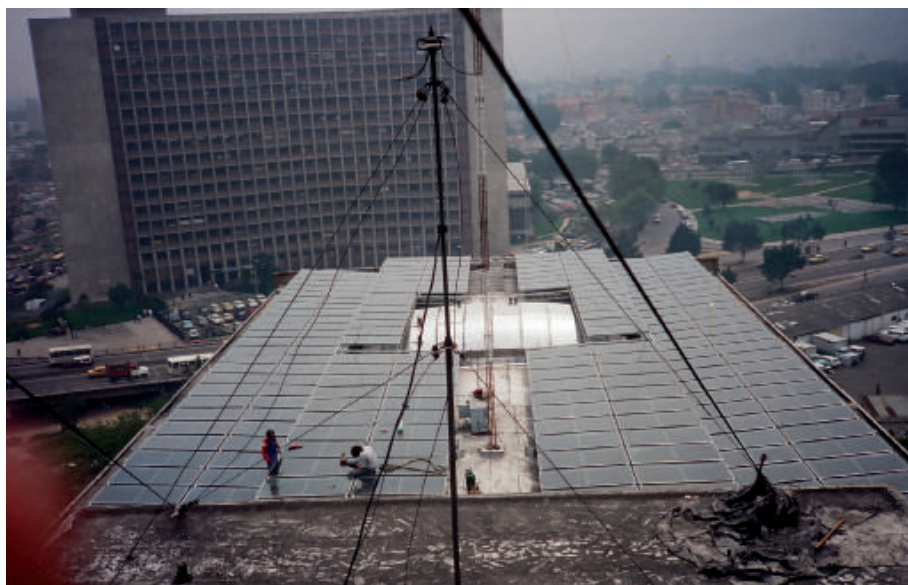
Instalación solar de GAVIOTAS para agua caliente en el Hospital Méderi en Bogotá
