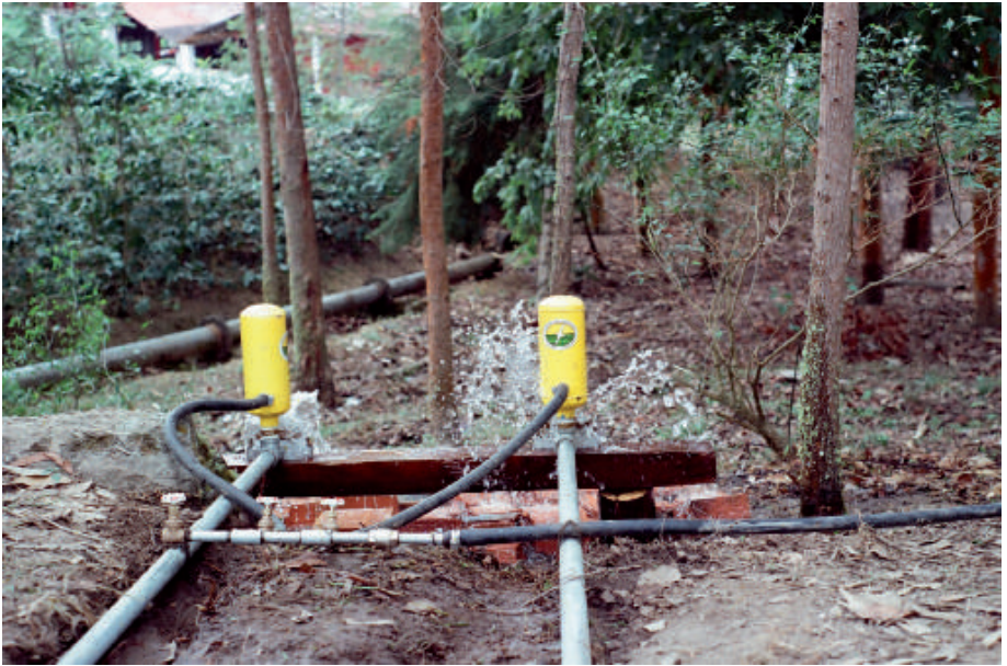
Microacueducto rural con arietes GAVIOTAS
