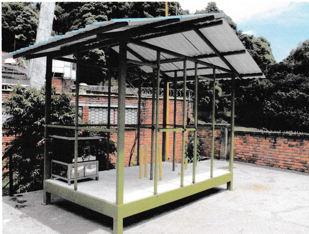
ASPECTO DE LA CONSTRUCCION EN MARCHA DE LA UNIDAD TERMICA AVANZADA PARA EL MEJORAMIENTO FAMILIAR UTRAF
