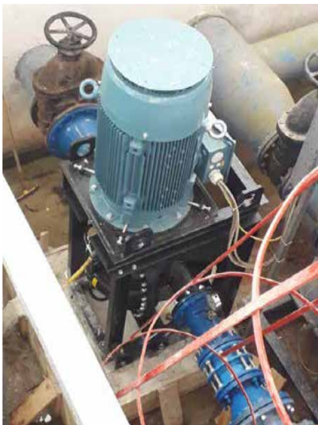
NR. 1 SKDVZ-4P 150-400 75kW
