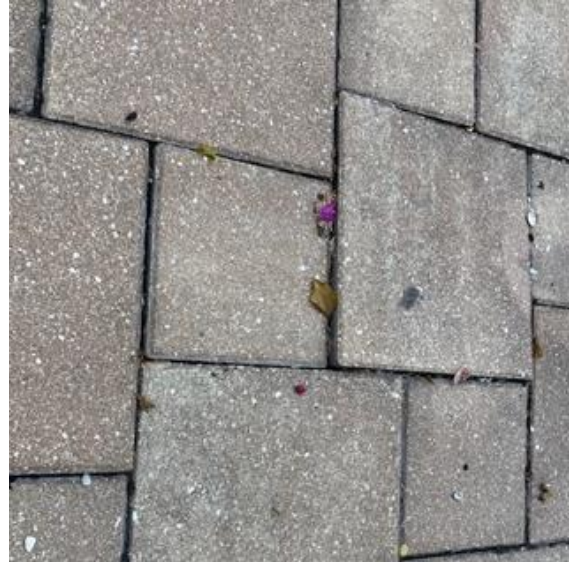
04.10.23 paver trip hazards
