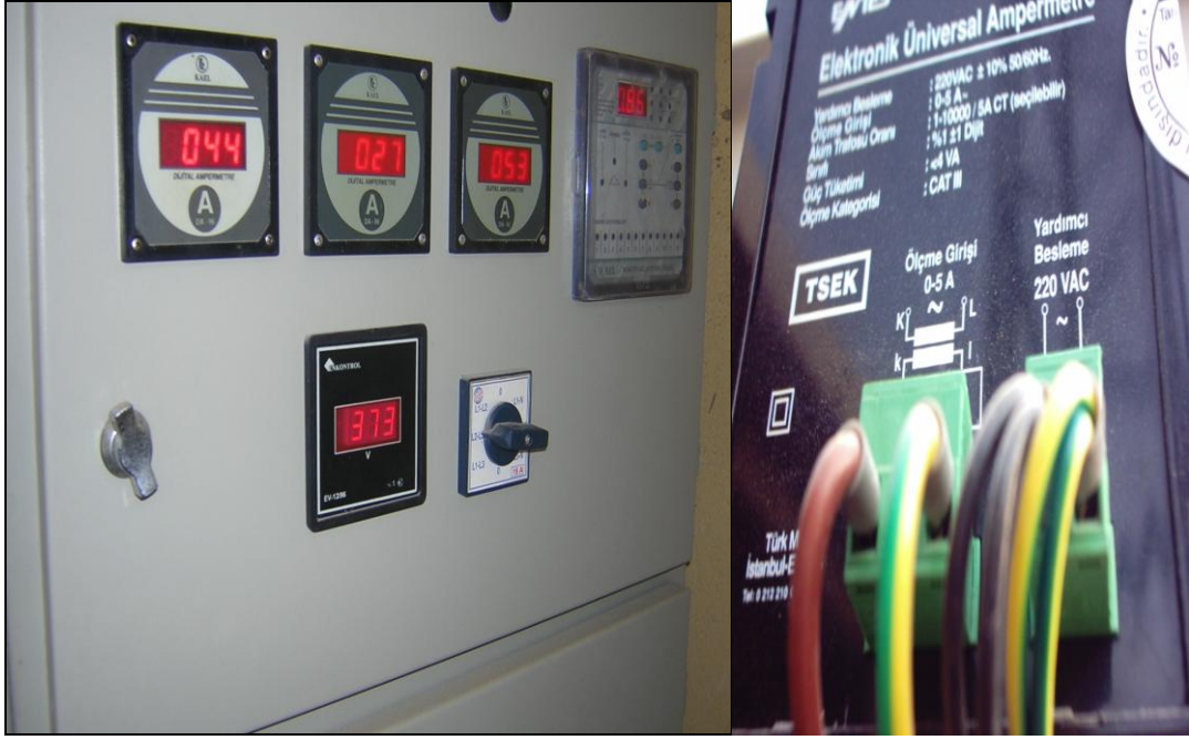
Resim 3.5: Ampermetre ve arka bağlantısı
