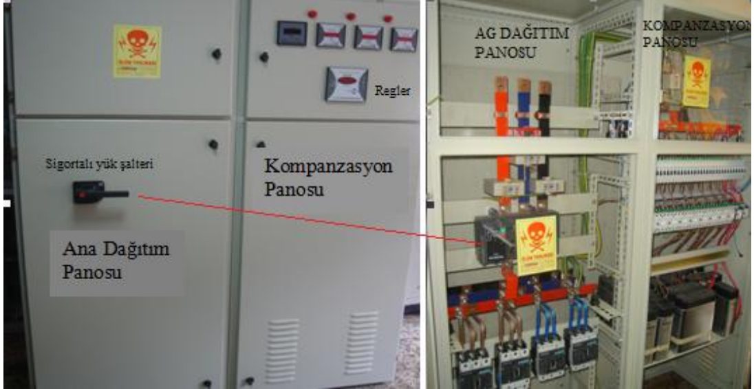
Resim 1.2: AG dağıtım pano ve kompanzasyon panosu
