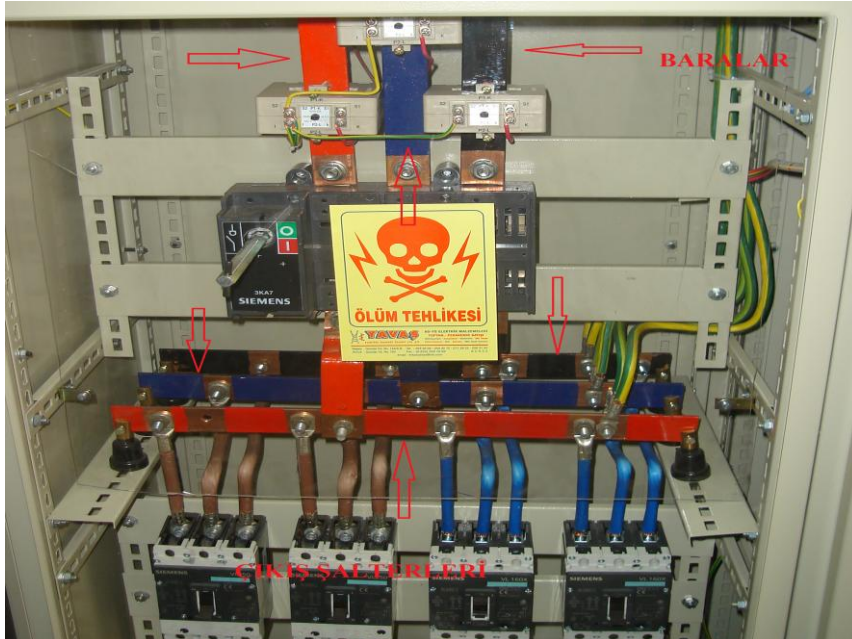
Resim 1.3: AG dağıtım panosunda bulunan bakır baraları
