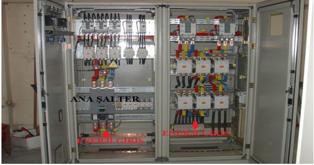
Resim 1.1: AG dağıtım panosu
