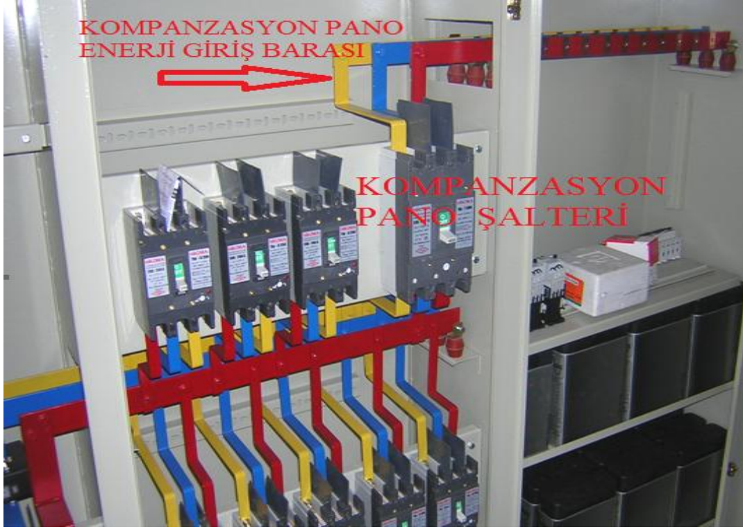
Resim 3.2: Kompanzasyon panosuna AG dağıtım panosundan enerji girişi
