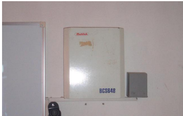
Resim 2.5: Bina içi telefon santrali
