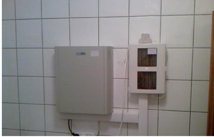
Resim 2.4: Bina içi telefon santrali
