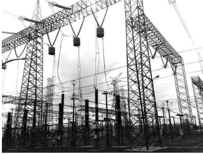
Resim 3.1: Şalt sahası ve elemanları.
