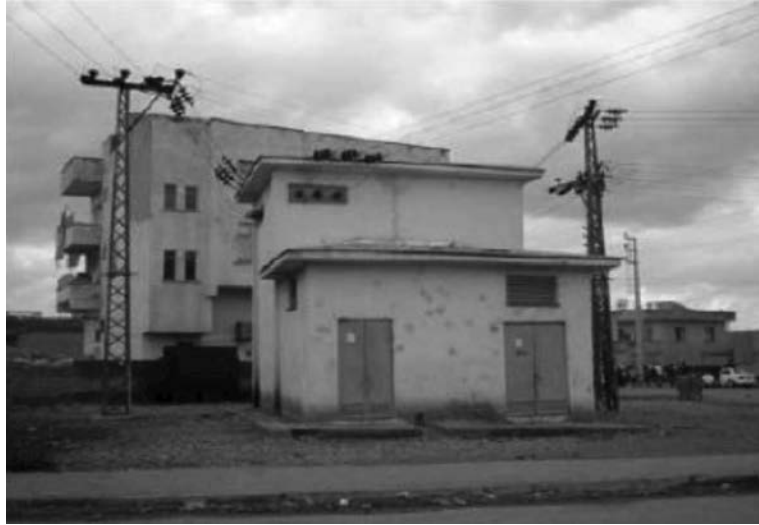
Resim 6.4: Bina tipi dağıtım transformatörü.
