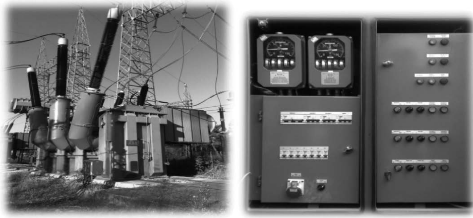
Resim 3.4: a) Güç trafosu.
