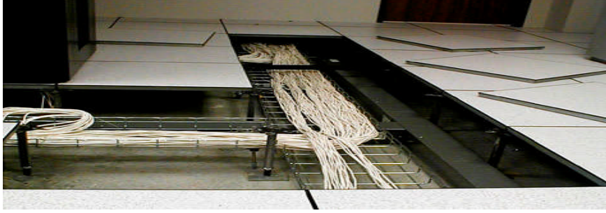
Resim 1.10: Döşeme altından yapılan, kablo kanallı bir kuvvet tesisatı örneği
