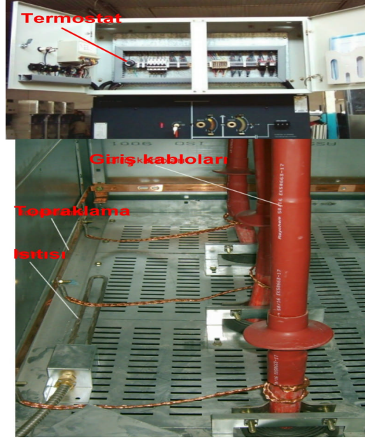
Resim 1.10: Isıtıcı ve termostatu
