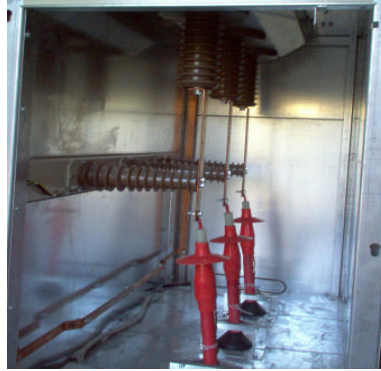
Resim 2.1: Modüler hücrelerde kabloların bağlantıları
