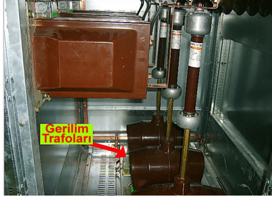
Resim 1.15: Hcre ierisindeki OG gerilim trafosu
