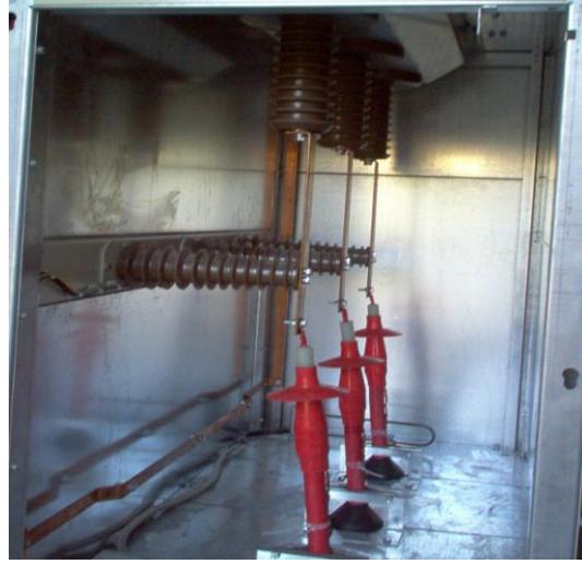
Resim 2.1: Modüler hücrelerde kabloların bağlantıları
