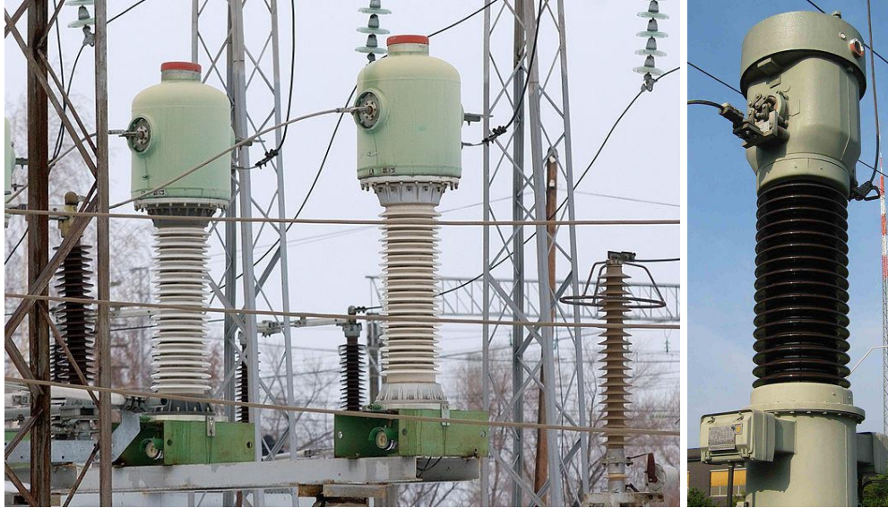
SF 6 110 kV Akım Trafosu
