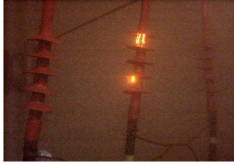
Resim 3.21: Kablo başlığında ark oluşumu
