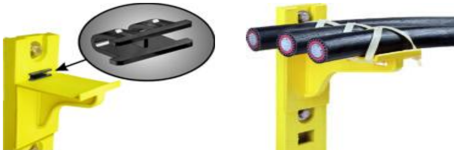
Şekil 2.18: Kablo balkonu (putrel) ve kablonun tutturulması
