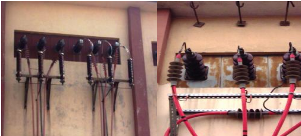
Resim 4.12: Trafo merkezine başlıklı kablo bağlantısı
