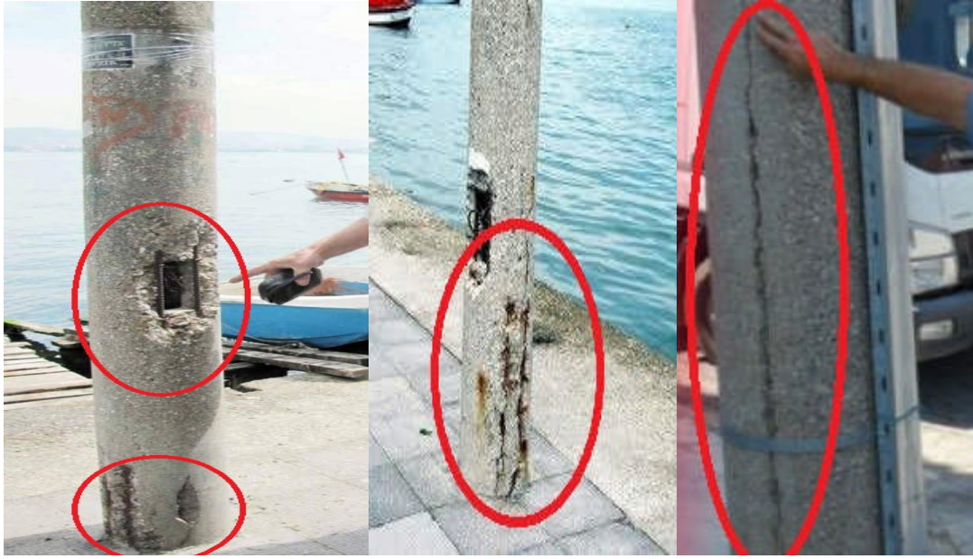
Resim 1.25: Beton direğin korozyona uğraması
