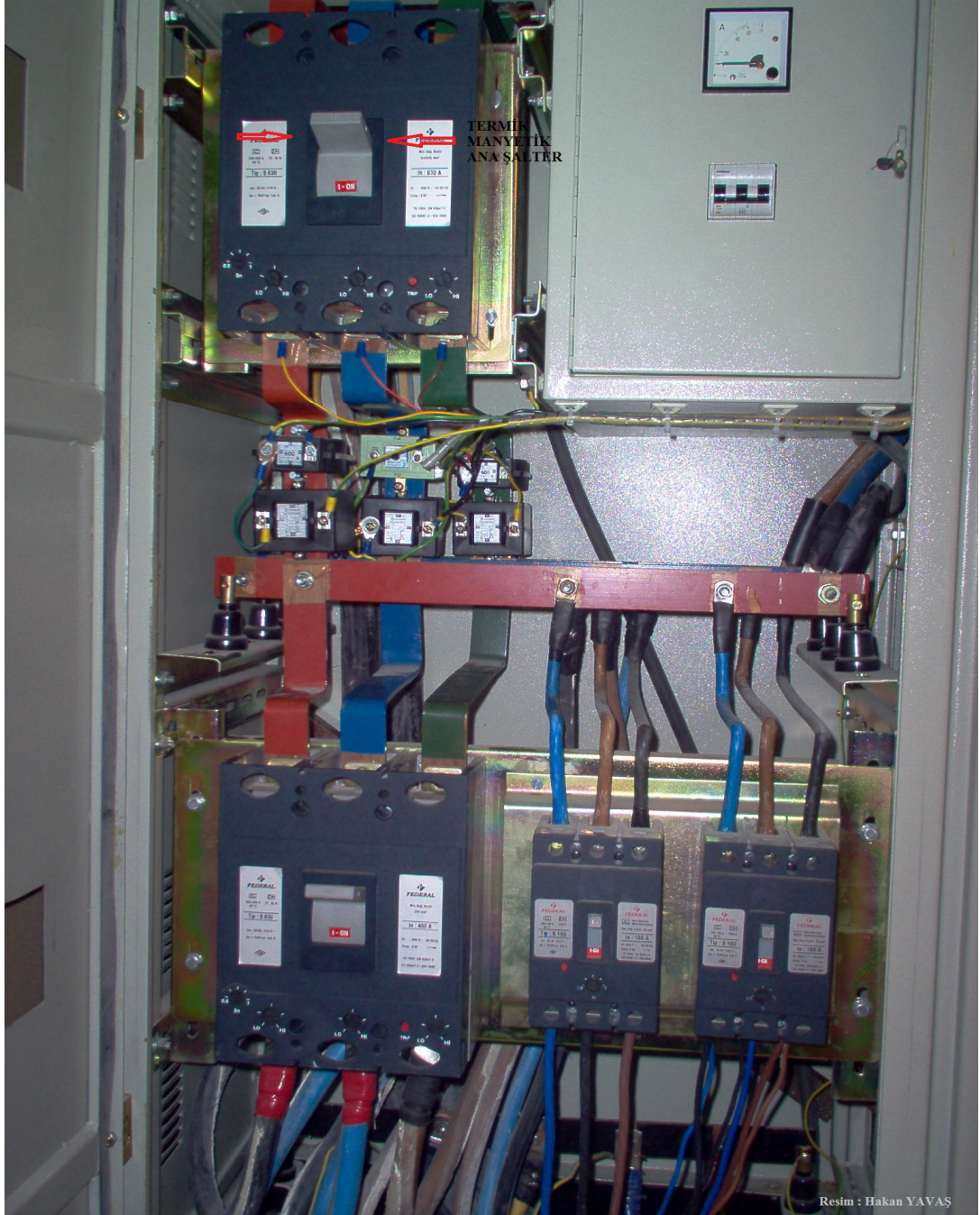
Resim 1.9: AG dağıtım panosunda bulunan termik manyetik şalterler
