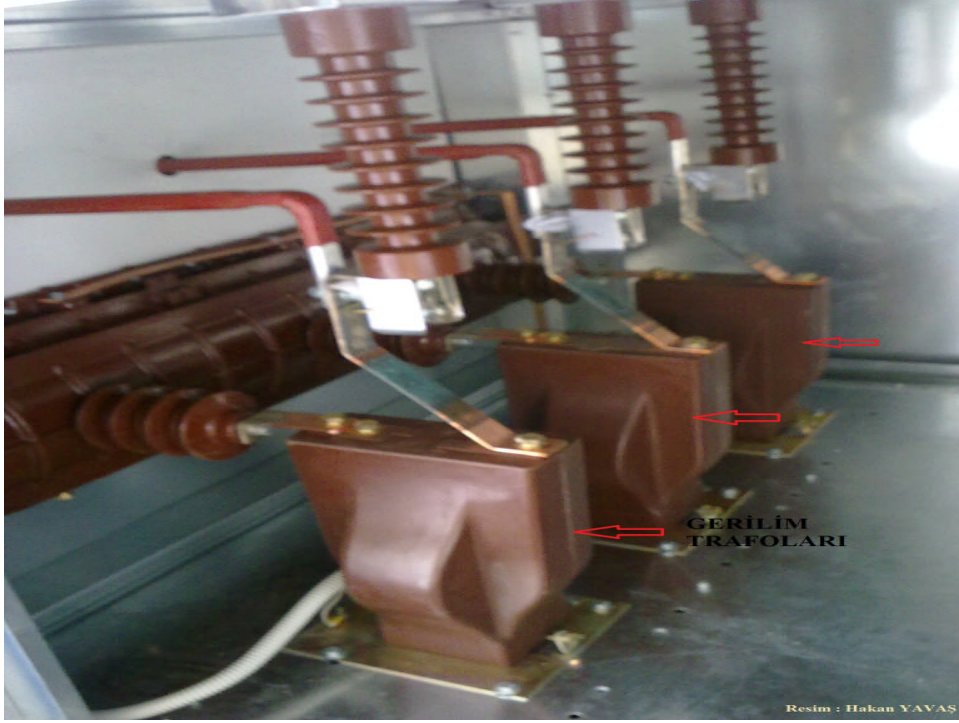
Resim 2.13: OG modüler hücrede gerilim trafosu
