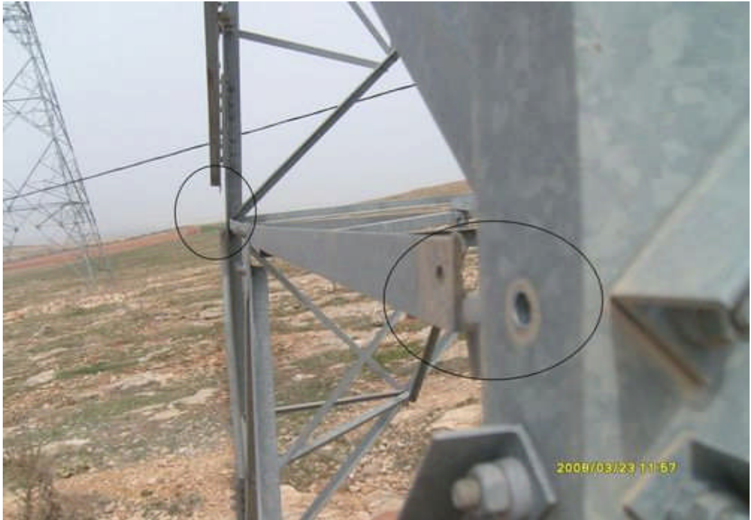
Resim 1.22: Ara bağlantı konsol cıvataları eksilmiş demir direk
