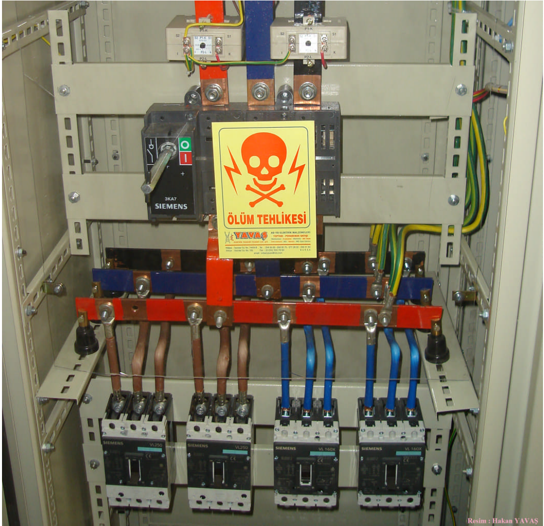
Resim 2.3: AG dağıtım panosu ve malzemeleri
