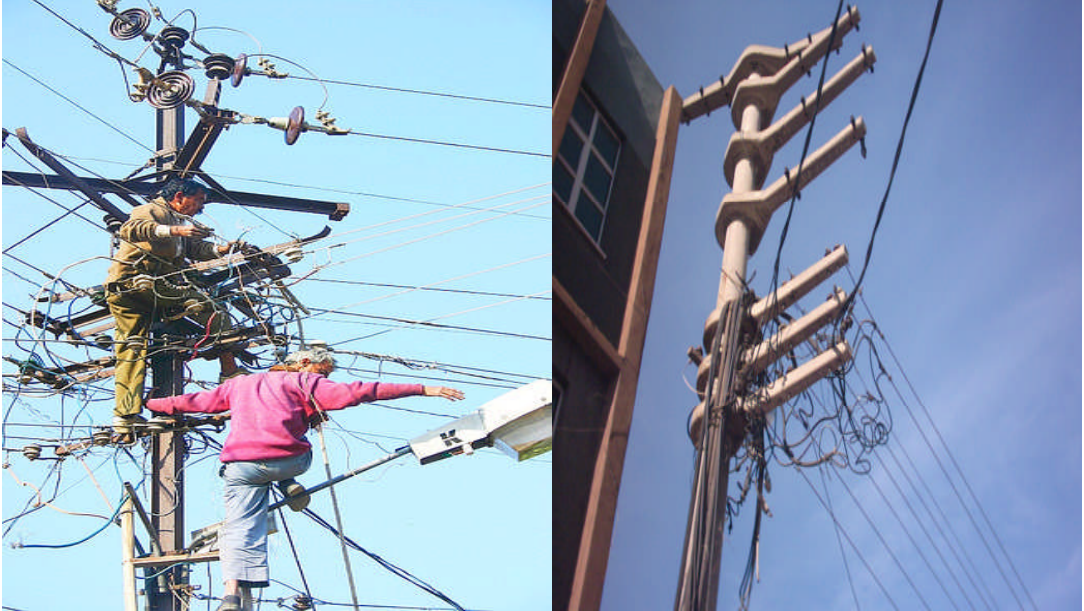
Resim 1.49: Hatalı, kötü havai hatlar
